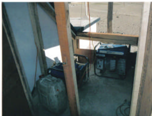
Foto 12 - I due generatori
