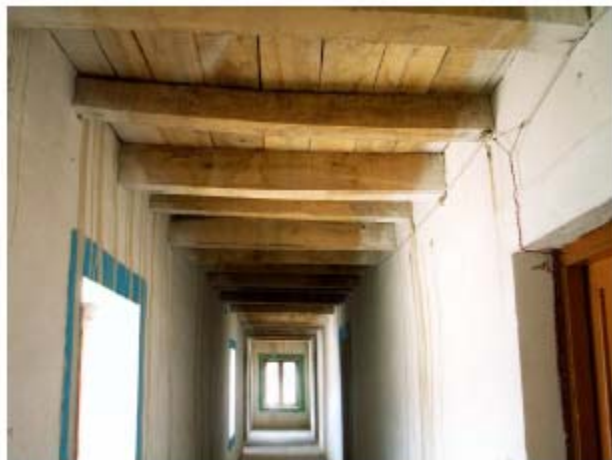
Les traces de fuites dans le couloir datent de l'hiver 2004/2005
